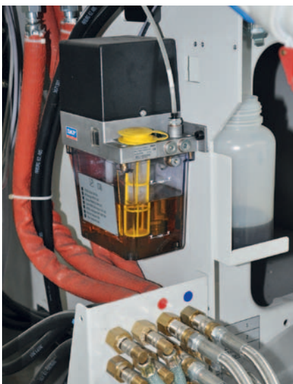
▲ Nachträglich isolierte wasserführende Kühlschläuche minimieren den Energieverlust.
